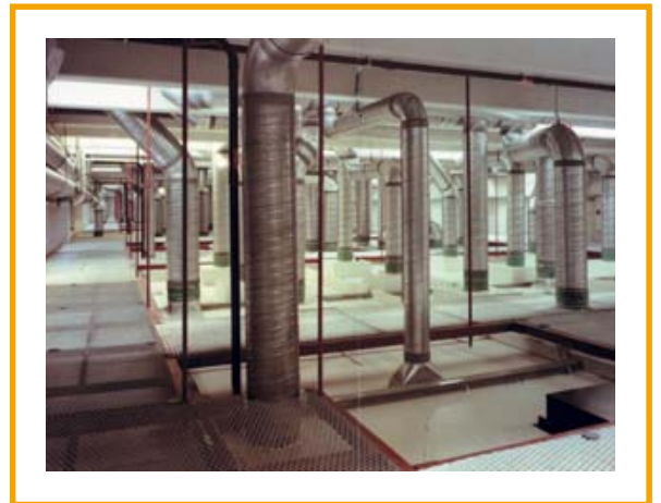
Ilmastointilaitteita, hepasuodattimia sekä huoltotasoja puhdistilan yläpuolella ja katon kannatuksia
